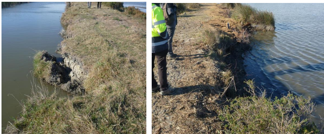
Figure 48. Marqueurs d'érosion externe de la digue sud
