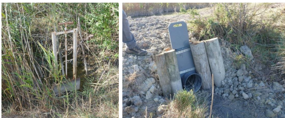
Figure 50. Vues d'une martelière dégradée (à gauche) et d'un busage neuf (à droite)
